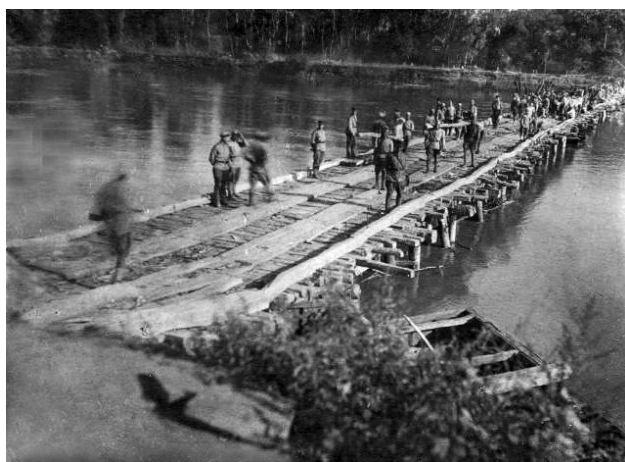
Строительство переправы через Днестр войнами 51-й инженерно-саперной бригады в районе Кицканско-Копанского плацдарма.
